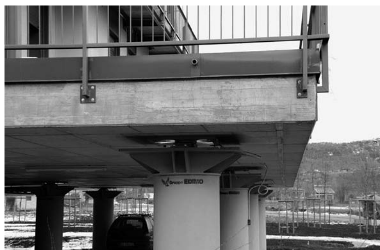
Particolare del dispositivo antisismico.
